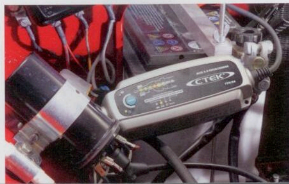
Nur selten unterwegs? Dauerladegeräte verlängern die Lebensdauer einer wenig genutzten Batterie erheblich
